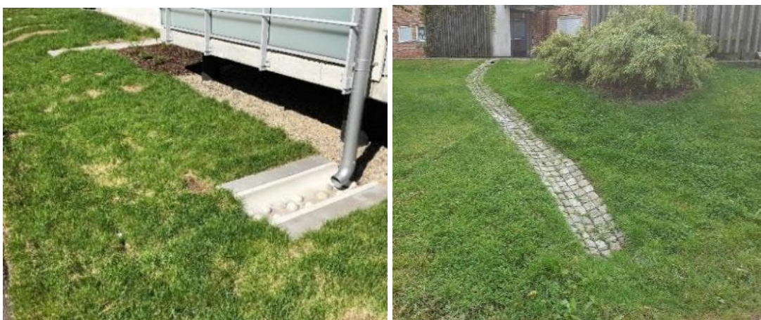
Figur 20 Utkastare med rännal till gräsyta
