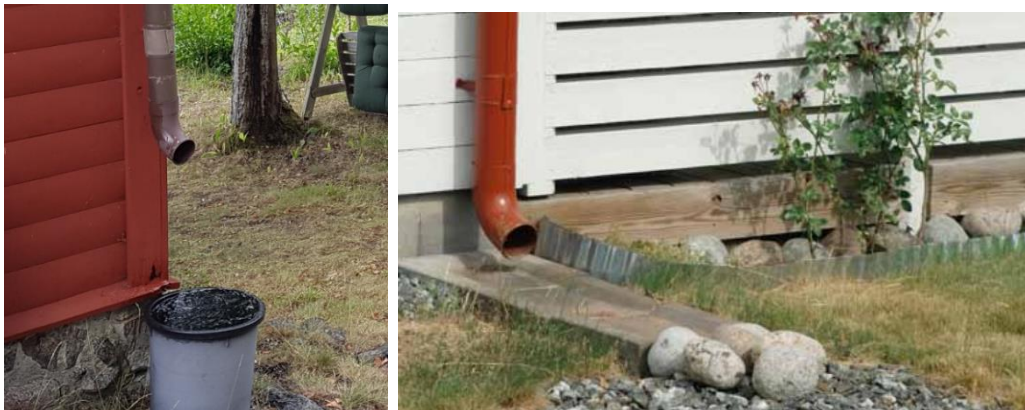
Figur 25 Stuprörsutkastare med regntunna (t.v.) och takvatten leds från stuprännan bort från husgrund mot ett erosionsskydd och vidare ner i makadambädd där infiltration kan ske (t.h.).
